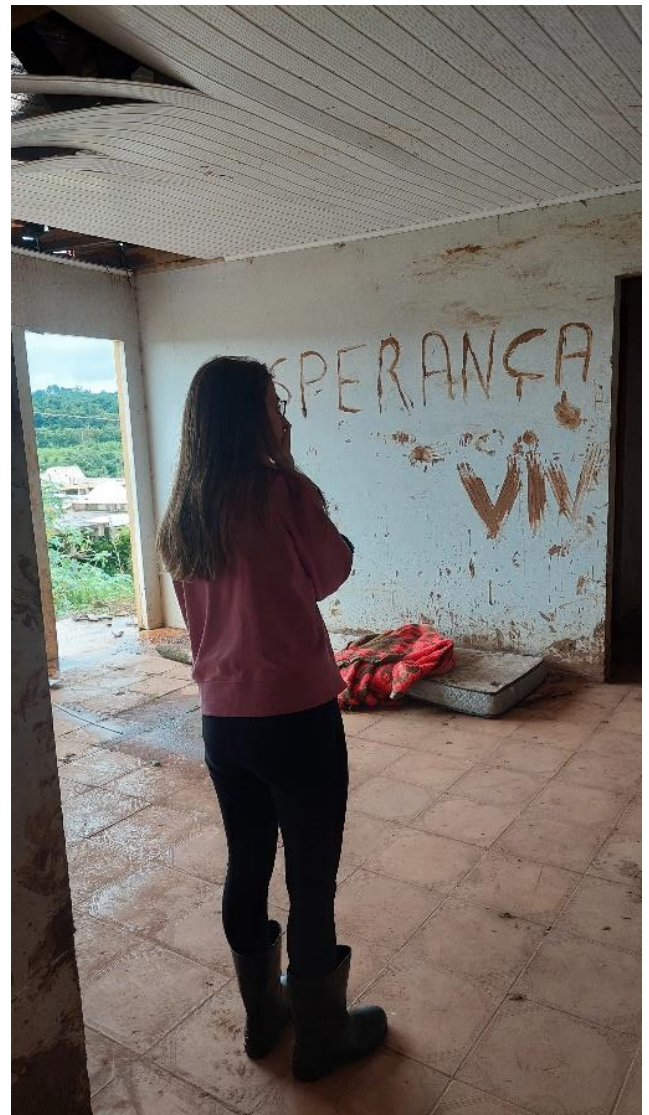
Die Auswirkungen der Flut sind in den übriggebliebenen Ruinen noch heute zu sehen, wie hier; im 2. Stock einer ehemaligen Pension. Foto: Teresa Liesenfeld
